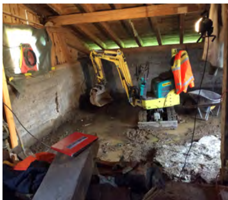
Wasserschaden bei Grabarbeiten
